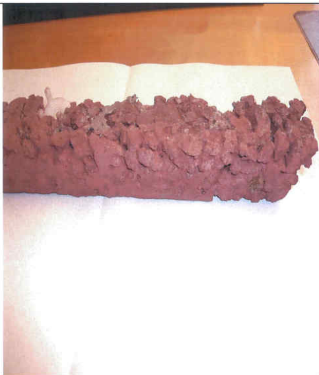
Betonen i "tåen" er ikke vibreret tilstrækkeligt sammen. Den er helt åben i strukturen, der tillader vand og luft at trænge ind til armeringen.
