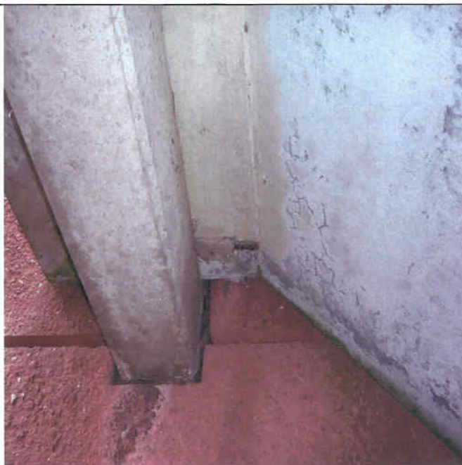
Eksempel på dæklagsskade i underside af trappeløb.
