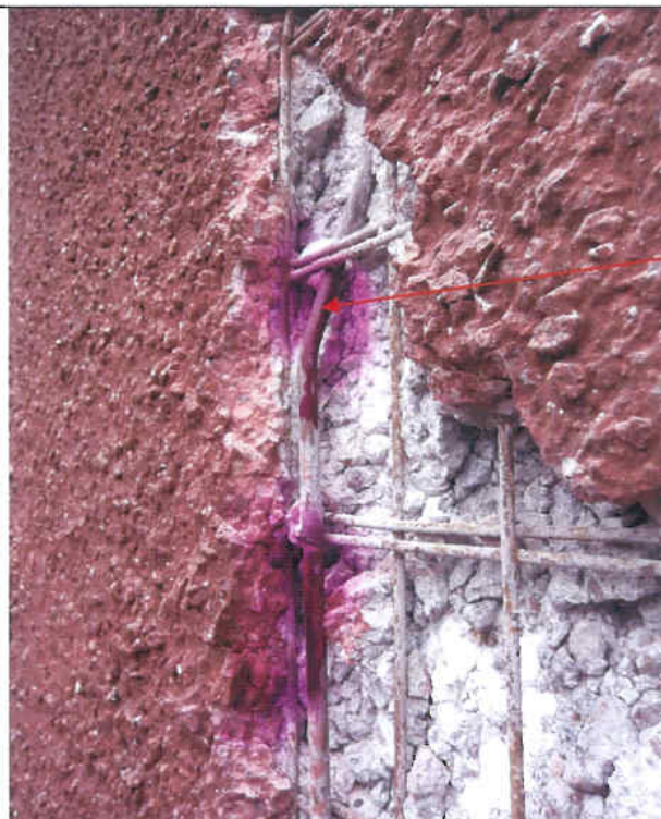
Store Torv 4. Frihugning af stritter for kontrol af forbindelse mellem for og bagplade, se ved rød pil. Stritteren er rundjern Ø 10 i rustfri udførelse.
