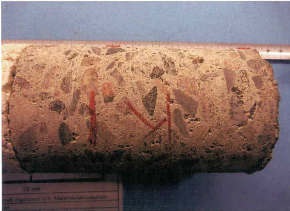
Kerne K1: Indvendig side af facadeelement, prøvehus - Høkerlængen 2. Udboringssiden på kernen (ydersiden) er ikke med i foto (ligger i retning mod venstre). Cementpastaen i betonen inderst er grå. Der ses en del luft i form af små til mellemstore kugleformede luftporer og irregulære luftindkapslinger.
