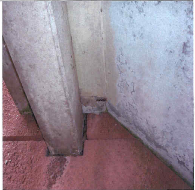
Eksempel på dæklagsskade i underside af trappeløb.
