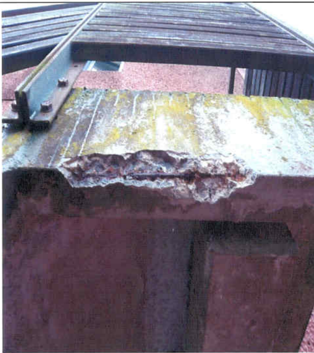
Afskalning over rusten armering.
