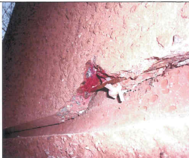
Løs beton er hugget af indtil fast beton. Noget af armeringen ligger i bagerste del af "tåen" med dæklag fra 10 mm. Dæklag til bund ca. 25 mm.
