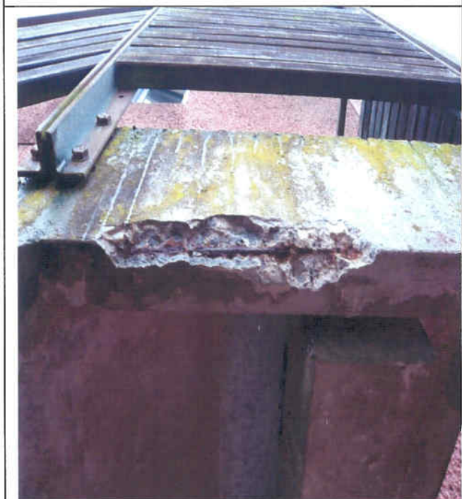
Afskalning over rusten armering.
