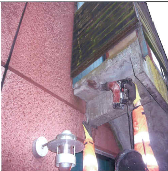
Mesterslippen 4. Nedhugning af stor skade, der var i fare for at falde ned. Bemærk meget rusten armering på grund af klorider.
