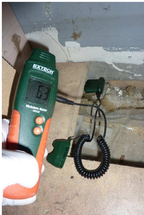
Måling af træfugt i strø under spånpladegulv
