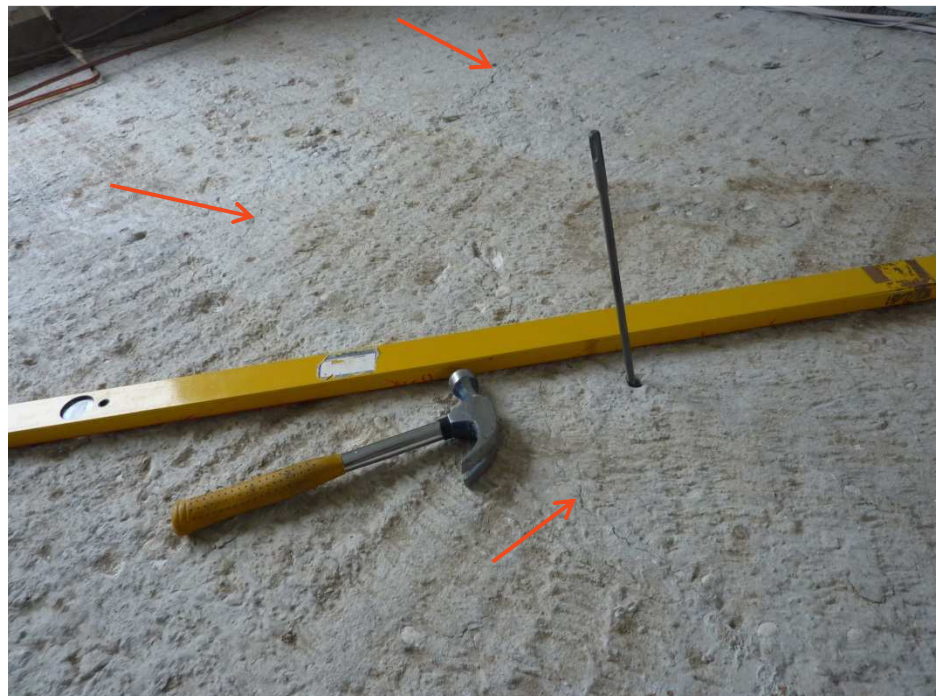
Revner i betondæk vist med pile. Hul i betondæk vist med jernstang.
