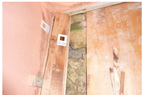
...og gulvbræt er efterfølgende taget op. Bemærk skimmel på tapetet.
