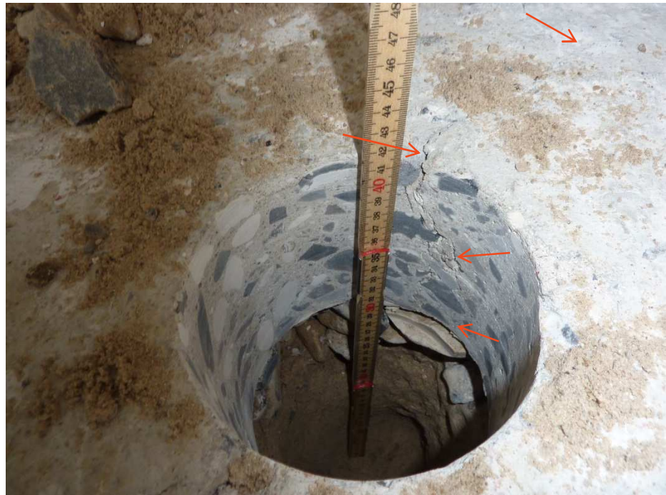
Udtaget borekerne i terrændæk. Synlig revne gennem betondækket
