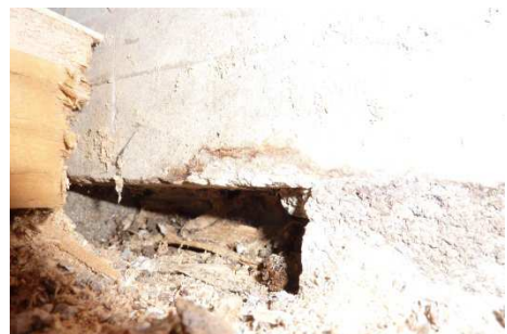
Opklodsning af facadeelement er rådnet væk
