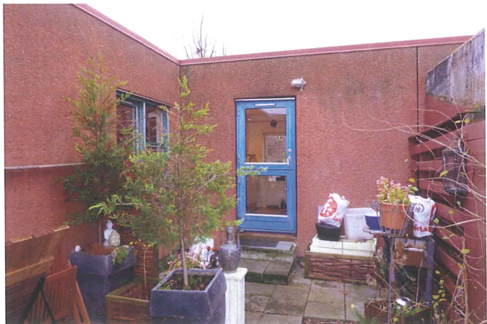
Foto af gårdhave. Ved dør kan det ses, at gulv overside er placeret cirka 20 cm over underkant af facadeelement.
