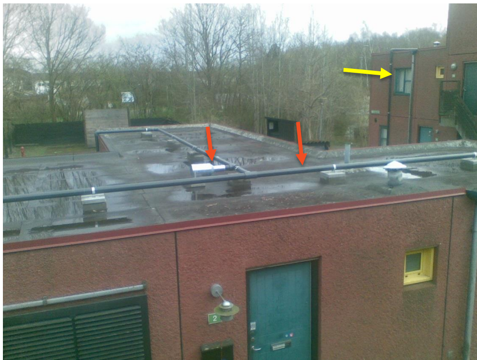
Foto viser installation på tag på Suderlængen 2 i forgrunden. Med røde pile er markeret kanalføring og ventilator med lyd-dæmper. I baggrunden ses markeret med gul pil lodret kanalføring for radonsug på Hjortelængen 20.
