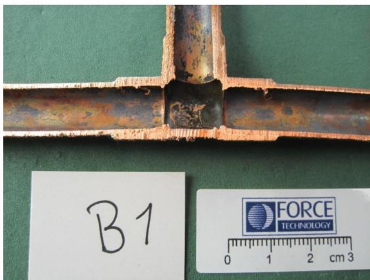
Figur 10 Indvendig overflade på Rørprøve B1 efter afrensning.
