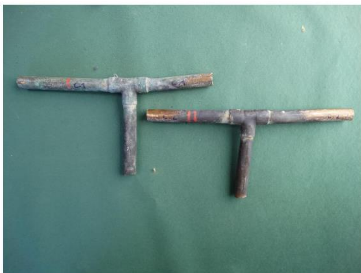
Figur 5 Rørprøver mærket Sadelstræde 1C. Grønlig og sorte belægninger.
