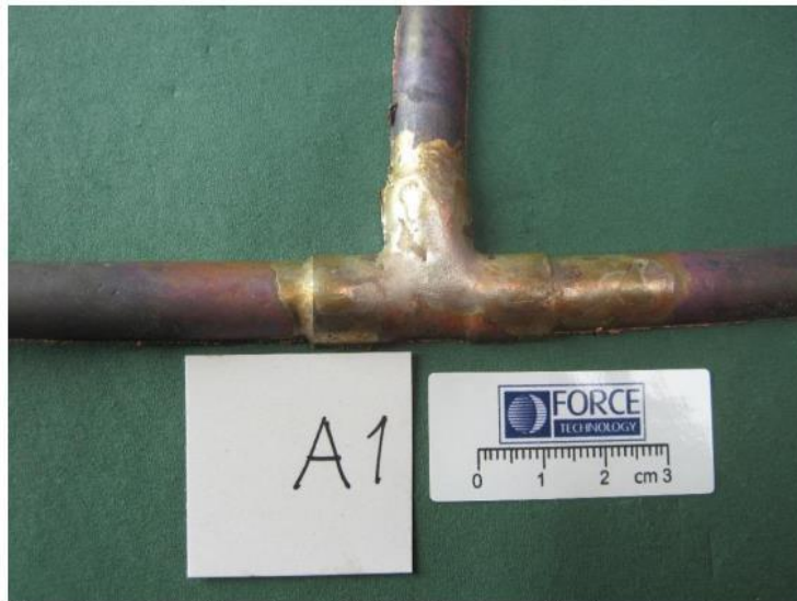
Figur 7 Udvendig overflade på Rørprøve A1 efter afrensning.
