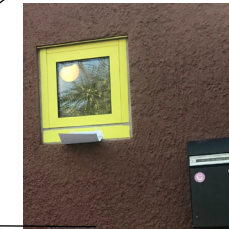
Badeværelsesvindue - forkert farve
